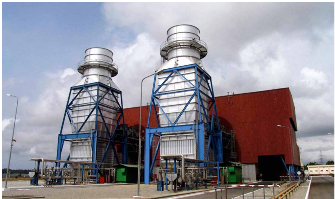
Azito Power Expansion Project, Côte d'Ivoire.
